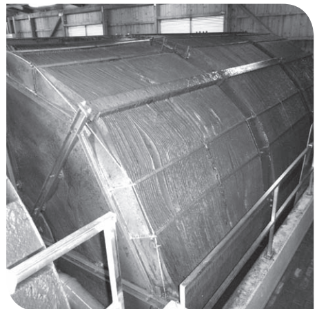
Reparatur benötigte Walze der Kläranlage
